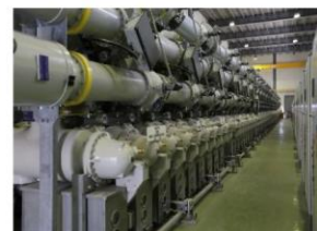
پست GIS در نیروگاه 1130 مگاواتی
