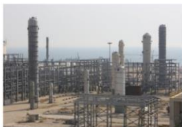
تجهیزات و سازه‌های فلزی
